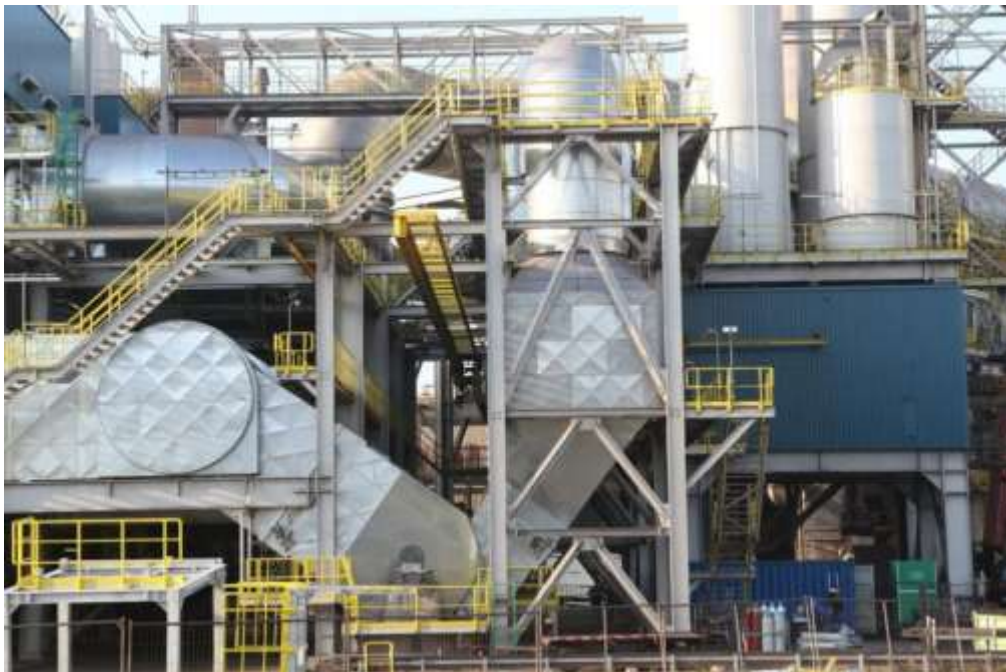
Figuur 4.2 De Doekfilterinstallatie (bron: Tata Steel)
